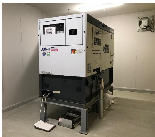
ディーゼルエンジン型発電機 (軽油, 50kVA)
