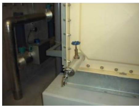
緊急時給水栓※25、※26
